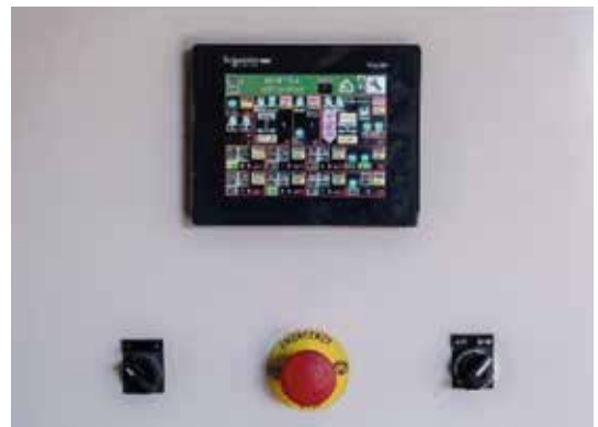
Τυπικός πίνακας ελέγχου μιας εγκατάστασης της ZEOLOGIC
