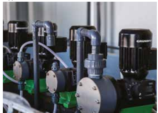
Αντλίες δοσομέτρησης αναλώσιμων
